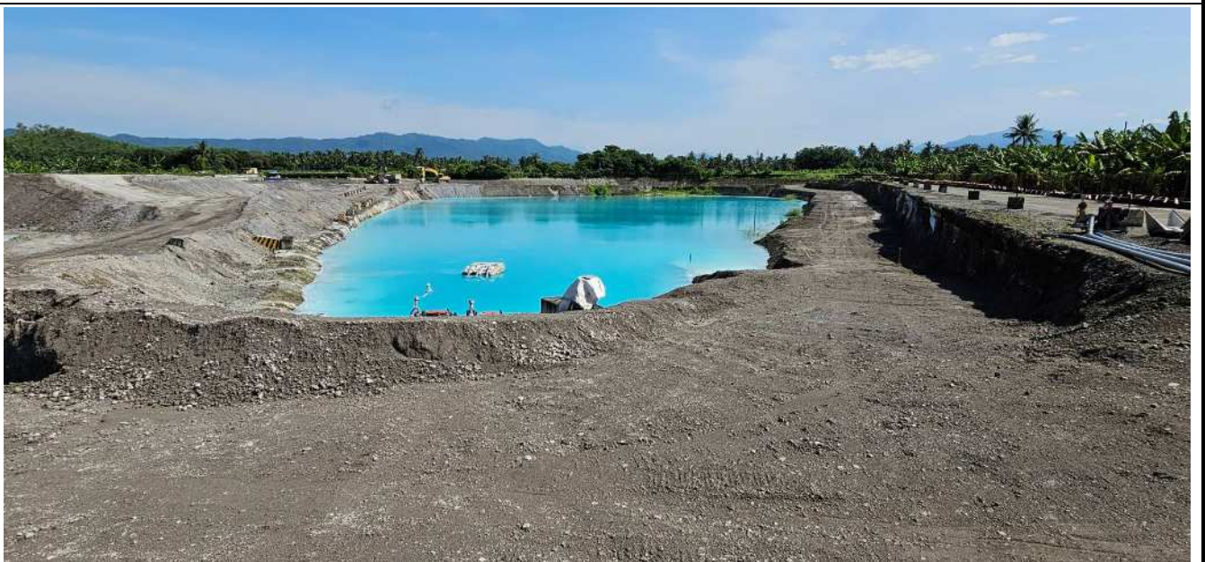
112 年 8 月中旬杜蘇芮、卡努颱風過後工區積水狀況(無法作業)
